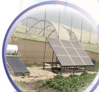
وحدة الطاقة الشمسية لمزارع الكلية
